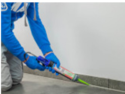
Sigillare lo spazio ricavato tra zoccolatura e pavimento con un idoneo sigillante elastico della gamma Mapei
